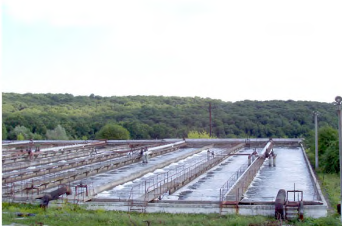
Каналізаційні очисні споруди МКП "Хмельницькводоканал", м. Хмельницький (потужність 75 тис. м 3 /добу. Загальний вид аеротенків)
